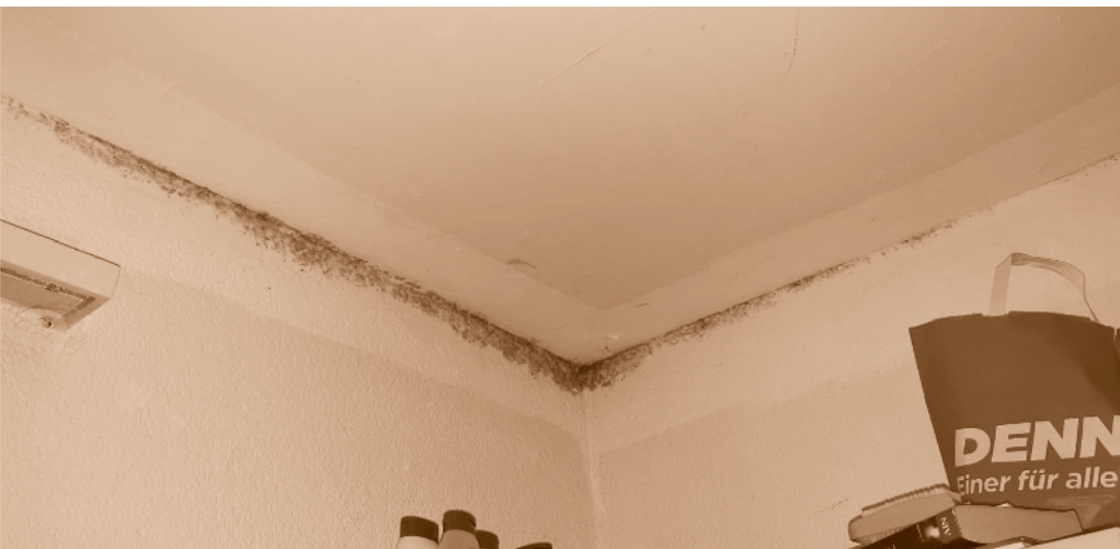
Faute d'entretien suffisant, les moisissures prospèrent.
